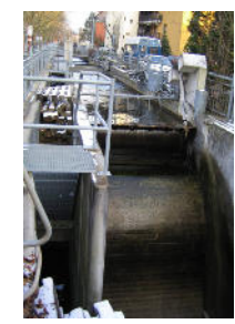
Rabenkopf, Kaplan turbine
